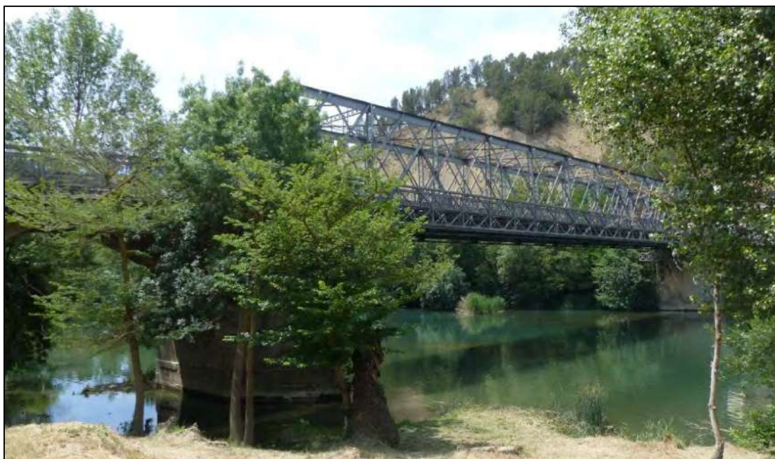
Figura 27. Fotografía del puente principal que da acceso al casco antiguo de Sangüesa. Este puente conecta la carretera NA-8603, con la propia calle mayor de la localidad.
